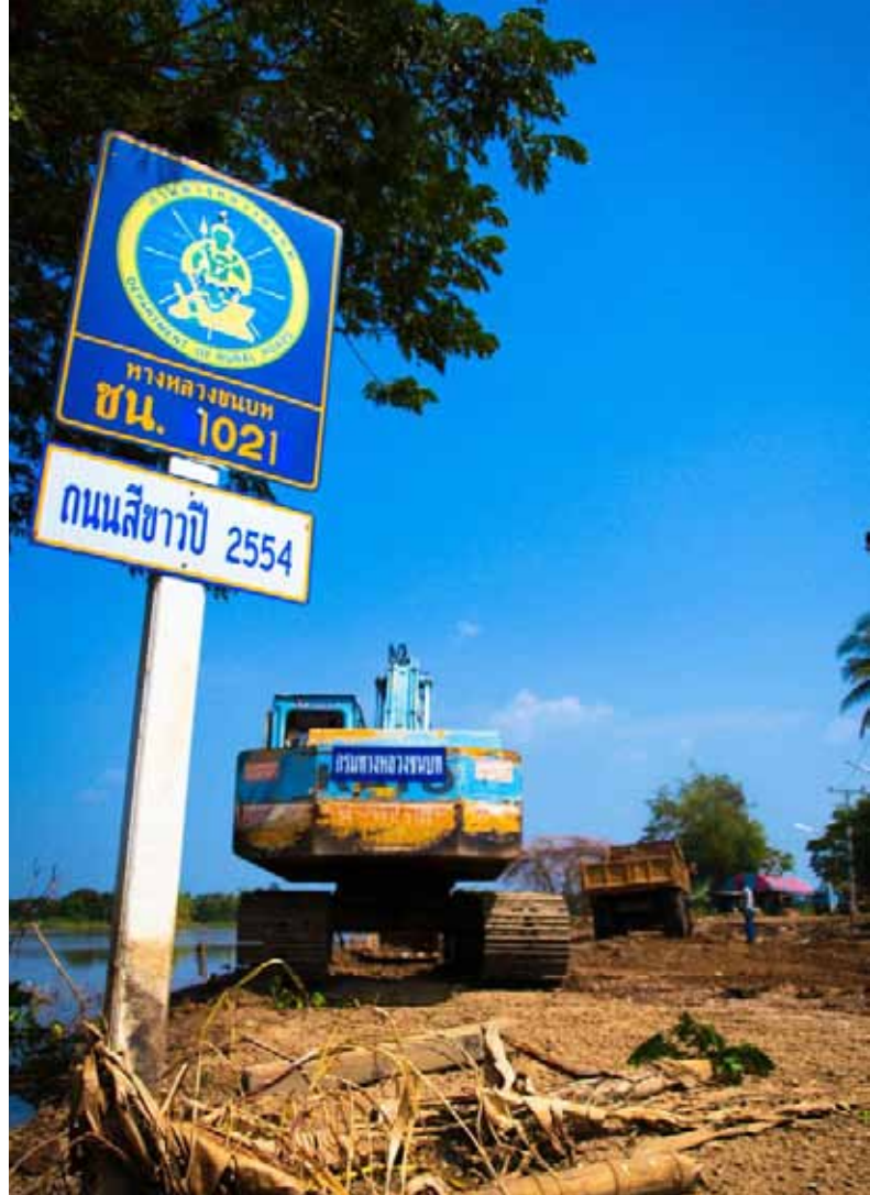
ทชจ.ชัยนาท ลงพื้นที่ซ่อมแซมถนนที่ได้รับ ความเสียหายจากเหตุอุทกภัย
